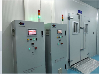
Zentrale Steuerung für den thermostatischen Raum
